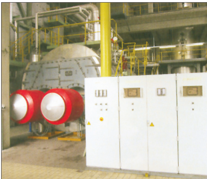
شکل ۱۷: کوره بخار فشار ضعیف (۱۰ بار) با تابلوی برق
